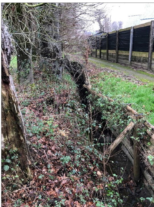
Photographie fossé exutoire (affaissement de berge)
